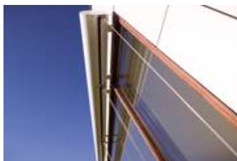
Udvendig solafskærmning på højisoleret bolig (foto: Rune Johansen)
